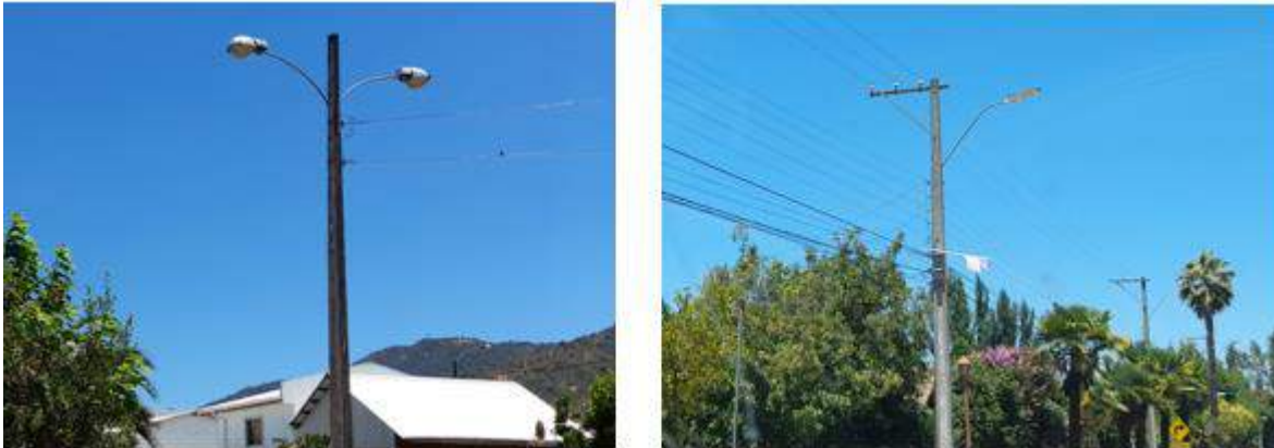
Ilustración 32 y 33: Luminaria pública de sodio de elata presión y LED en la comuna de Rauco
