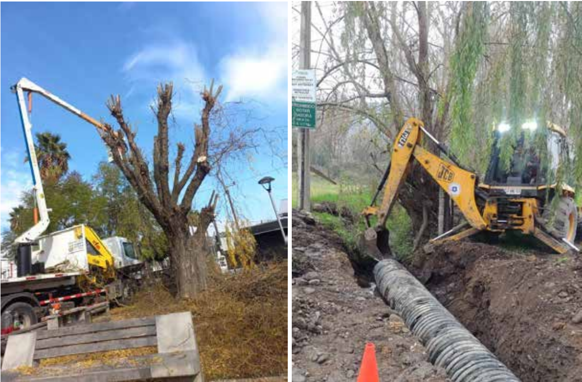
Podas y cortes de árboles Zona contigua a Viviendas o que presente peligrosidad
